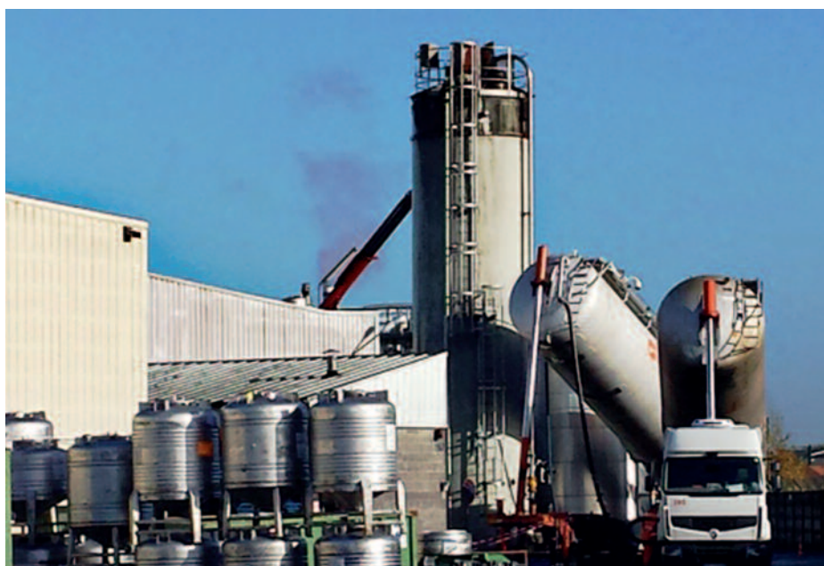
► Mise en place de la citerne sur le site de LACTALIS NUF / Installation of the tank on the LACTALIS NUF industrial site (doc. Transports GODEFROY).
